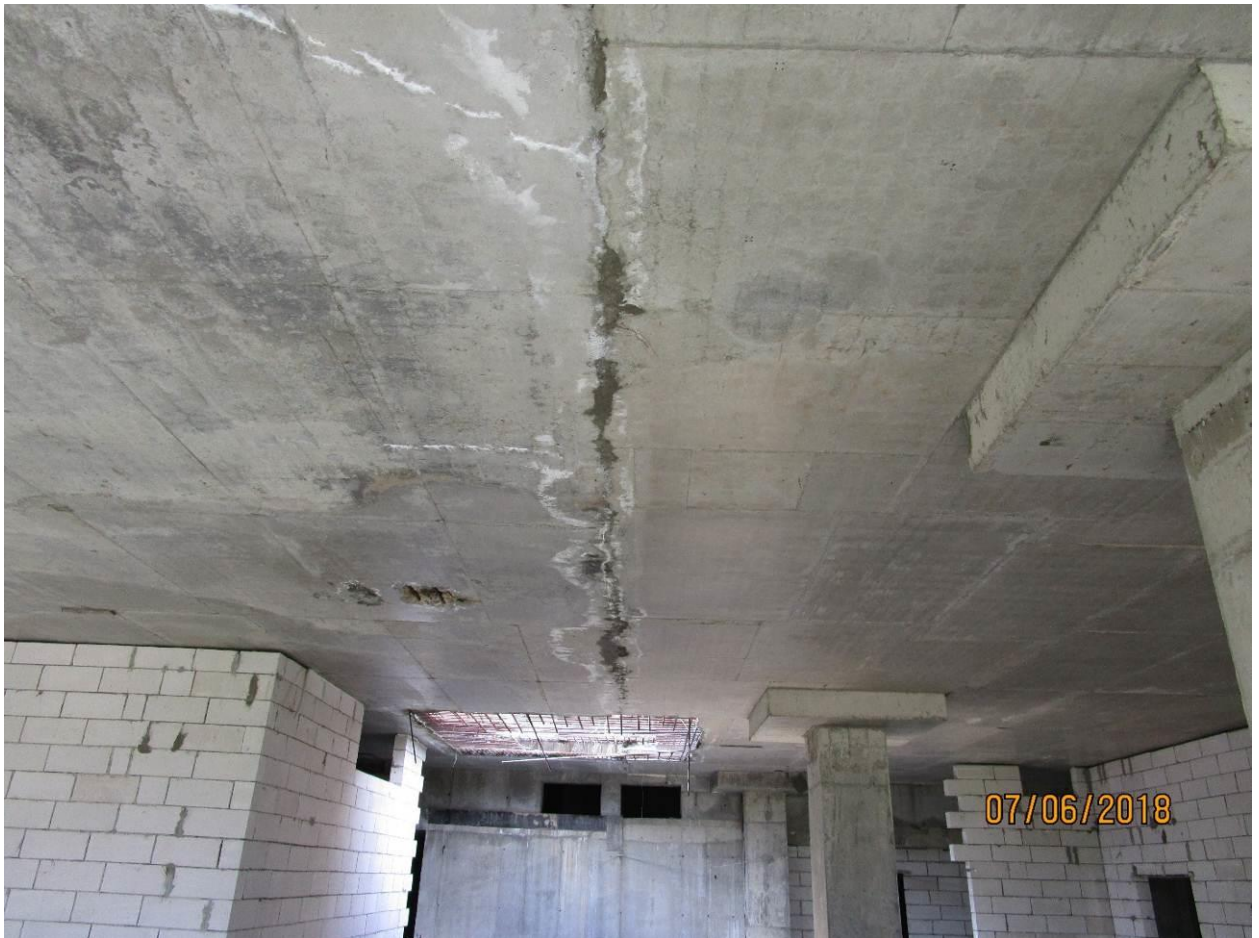
Фото 14. В покрытии стилобата в осях 12-15/В-Г на отм 12,200 в рабочем шве при бетонировании отсутствует прочность контакта поверхностей бетона.
