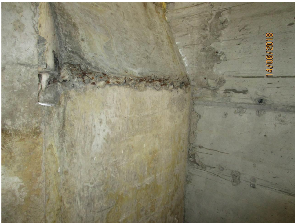
Фото 33. Примыкание лестничного марша к площадке имеет холодный шов, отсутствует уплотнение и однородность бетонной конструкции, оголена арматура в осях ВК/В8-В9 с отм. 43,800 (13 эт.).
