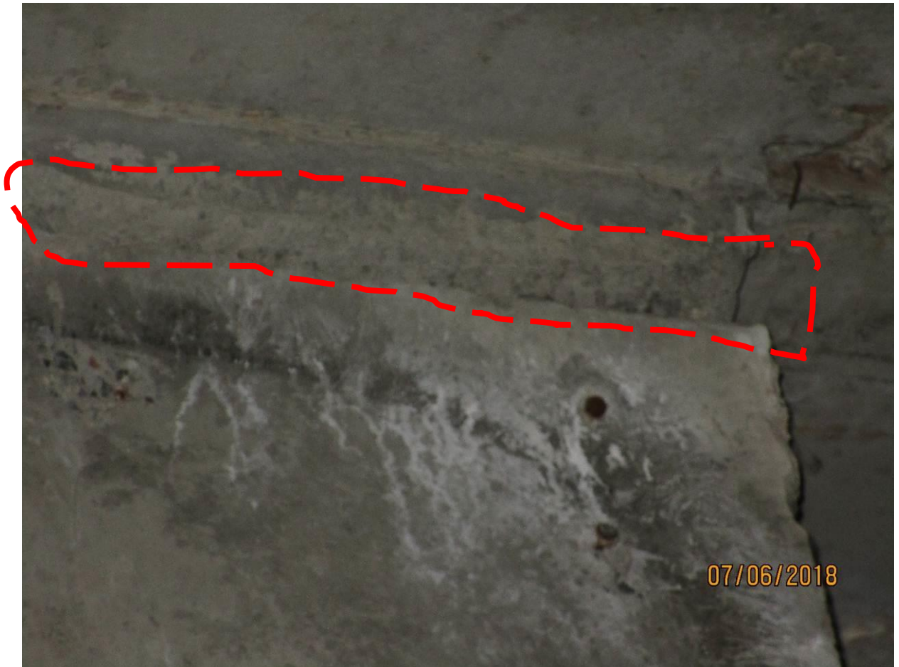
Фото 4. При примыкании стен в осях 18-19/Л, 18-19/М на отм. 3,800 к плите перекрытия имеются полости пустот.
