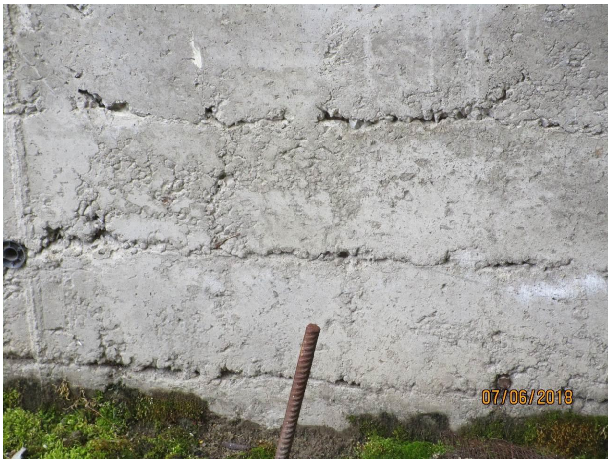
Фото 11. Бетон в стене в осях 10-11/Н с отм. 4,200 недоуплотнен до однородного состояния.
