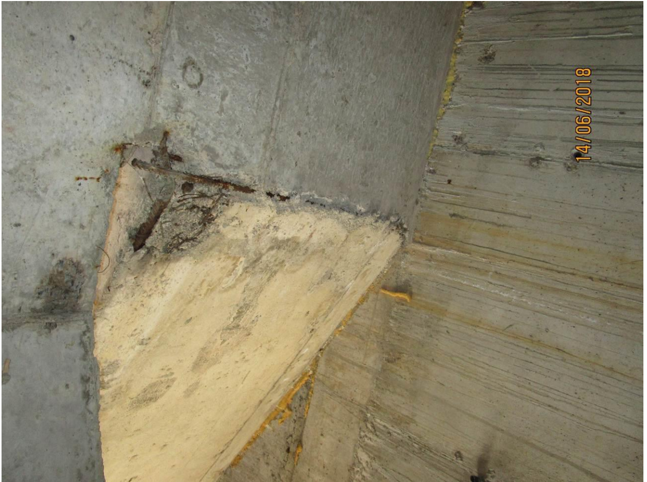
Фото 32. Примыкание лестничного марша к площадке имеет холодный шов, отсутствует уплотнение и однородность бетонной конструкции, оголена арматура в осях ВВ/В7-В8 с отм. 43,800 (13 эт.).
