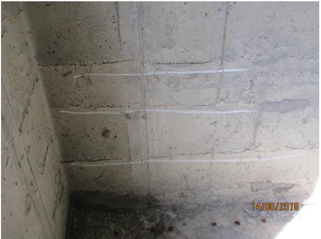
Фото 19. В конструкции ограждения лоджии в осях АА/А1 с отм. 17,400 оголение арматурного каркаса.
