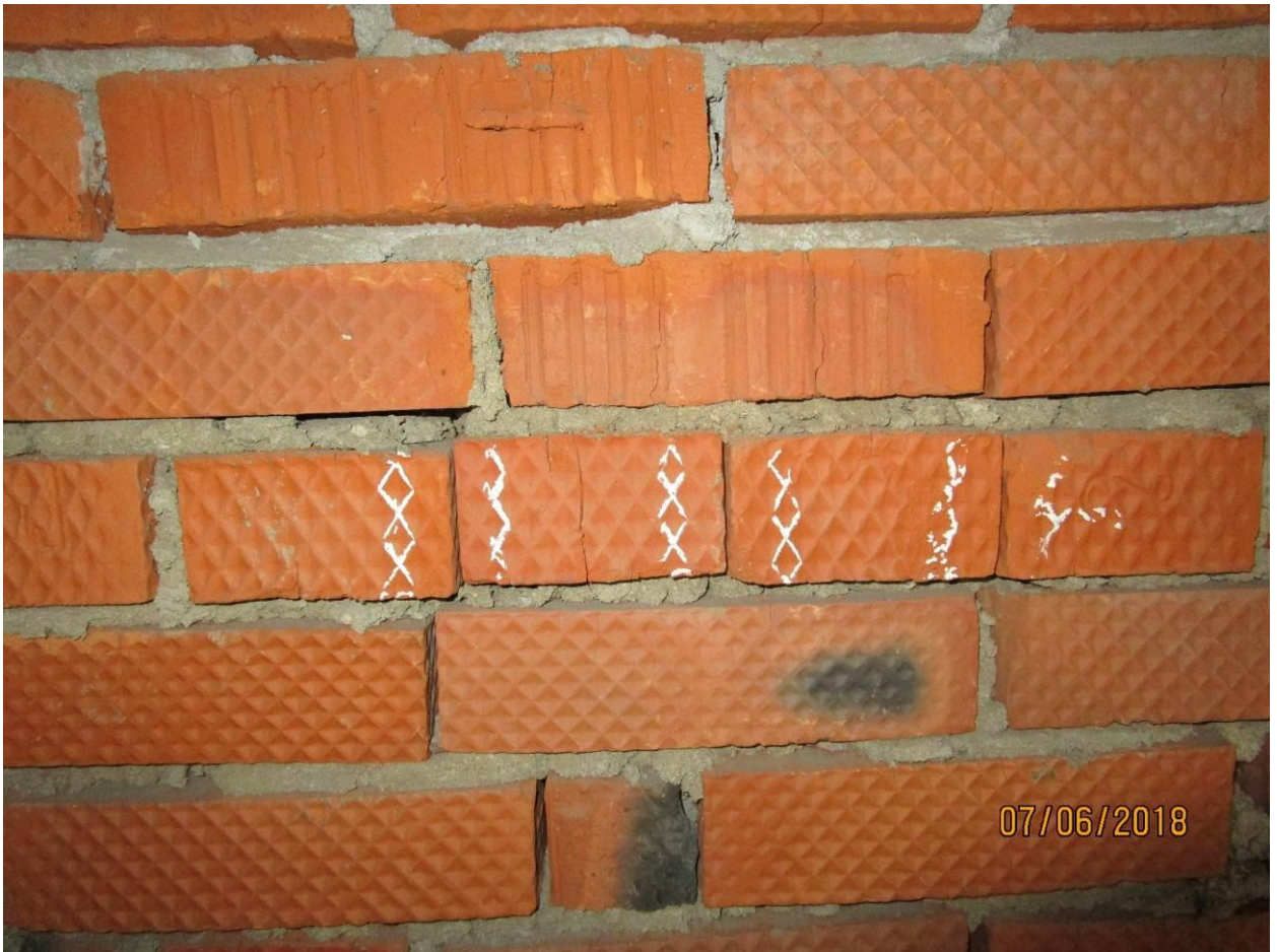
Фото 7. Отсутствует заполнения вертикальных швов в кирпичной кладке в осях 19-20/И-Ж с отм. 0,000. Массовый характер.
