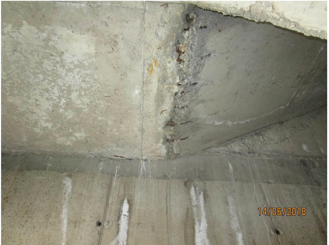
Фото 22. Примыкание лестничного марша к площадке имеет холодный шов, отсутствует уплотнение и однородность бетонной конструкции, оголена арматура в осях АЕ/А11-А15 с отм. 20,700 (6 эт.).
