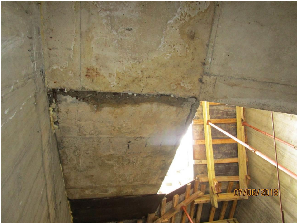
Фото 13. Примыкание лестничного марша к площадке имеет холодный шов, отсутствует уплотнение и однородность бетонной конструкции в осях 12-13/И-Ж на отм. 8,400.
