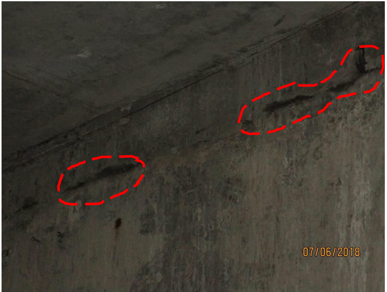
Фото 3. При примыкании стен в осях 18-19/Л, 18-19/М на отм. 3,800 к плите перекрытия имеются полости пустот.
