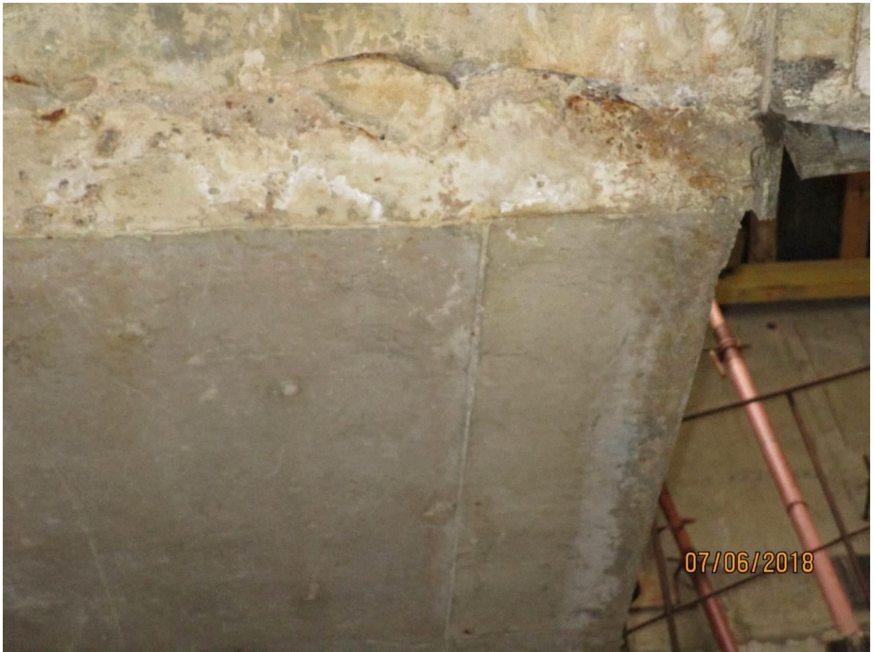
Фото 9. Примыкание лестничного марша к площадке имеет холодный шов, отсутствует уплотнение и однородность бетонной конструкции в осях 12-13/И-Ж на отм. 4,200.
