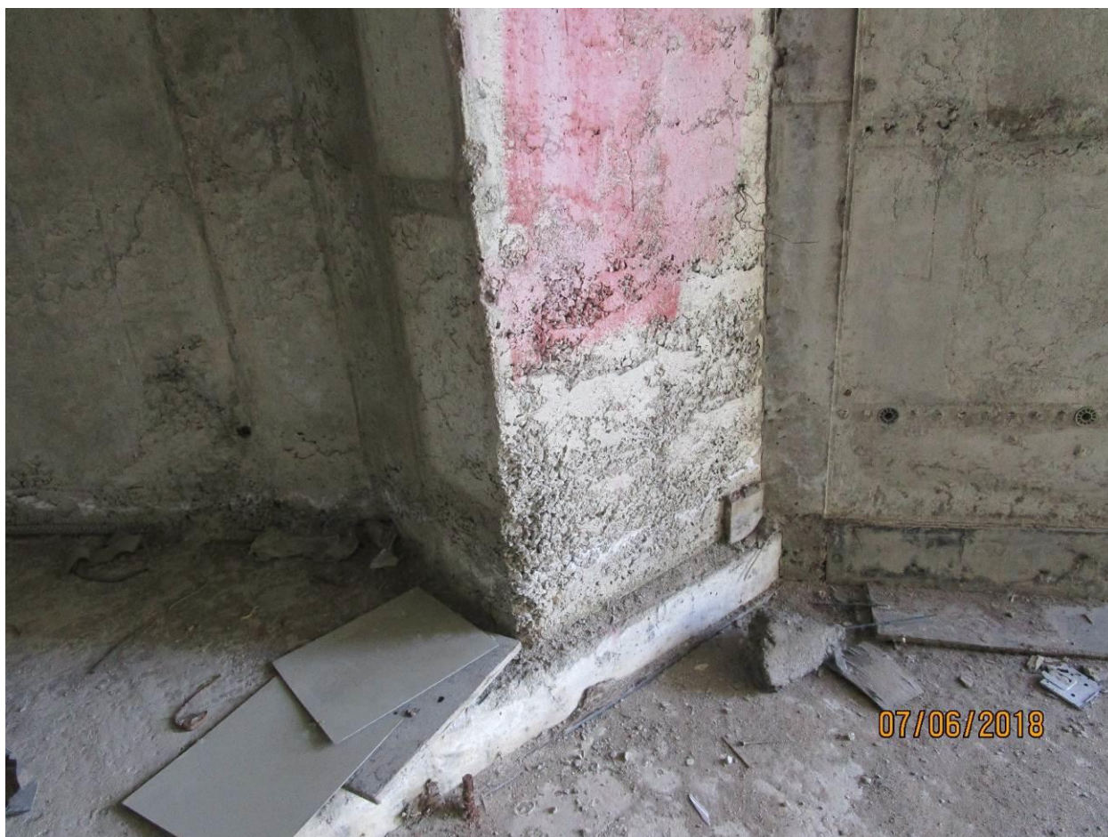
Фото 1. Бетонн в колонна в осях 7/д с отм. - 0,050 недоуплотнен до однородного состояния.
