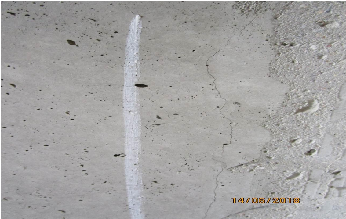
Фото 20, 21. В конструкции стены в осях АЕ/А11-А15 с отм. 17,400 трещины 2 шт по 0,15 мм.
