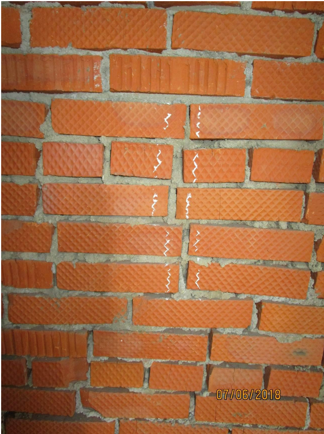
Фото 6. Отсутствует перевязка швов в кирпичной стене в осях 19-20/И-Ж с отм. 0,000. Массовый характер.
