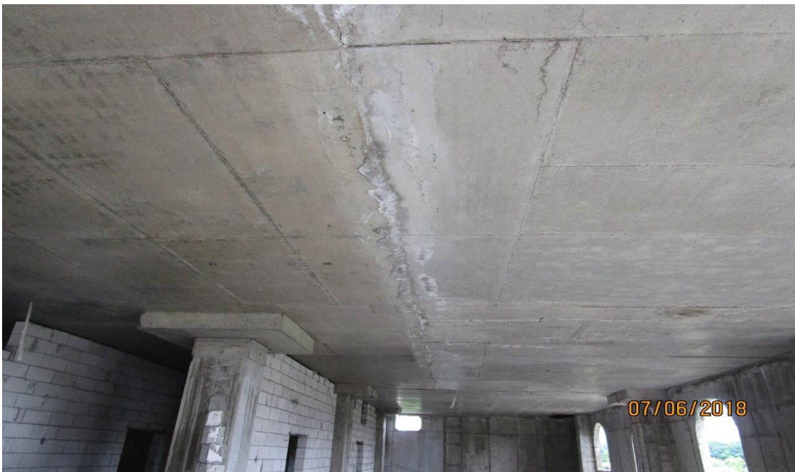
Фото 16, 17, 18. В конструкции покрытия стилобата в осях 12-15/В-Г на отм 12,200 оголена арматура и в рабочем шве при бетонировании отсутствует прочность контакта поверхностей бетона.
