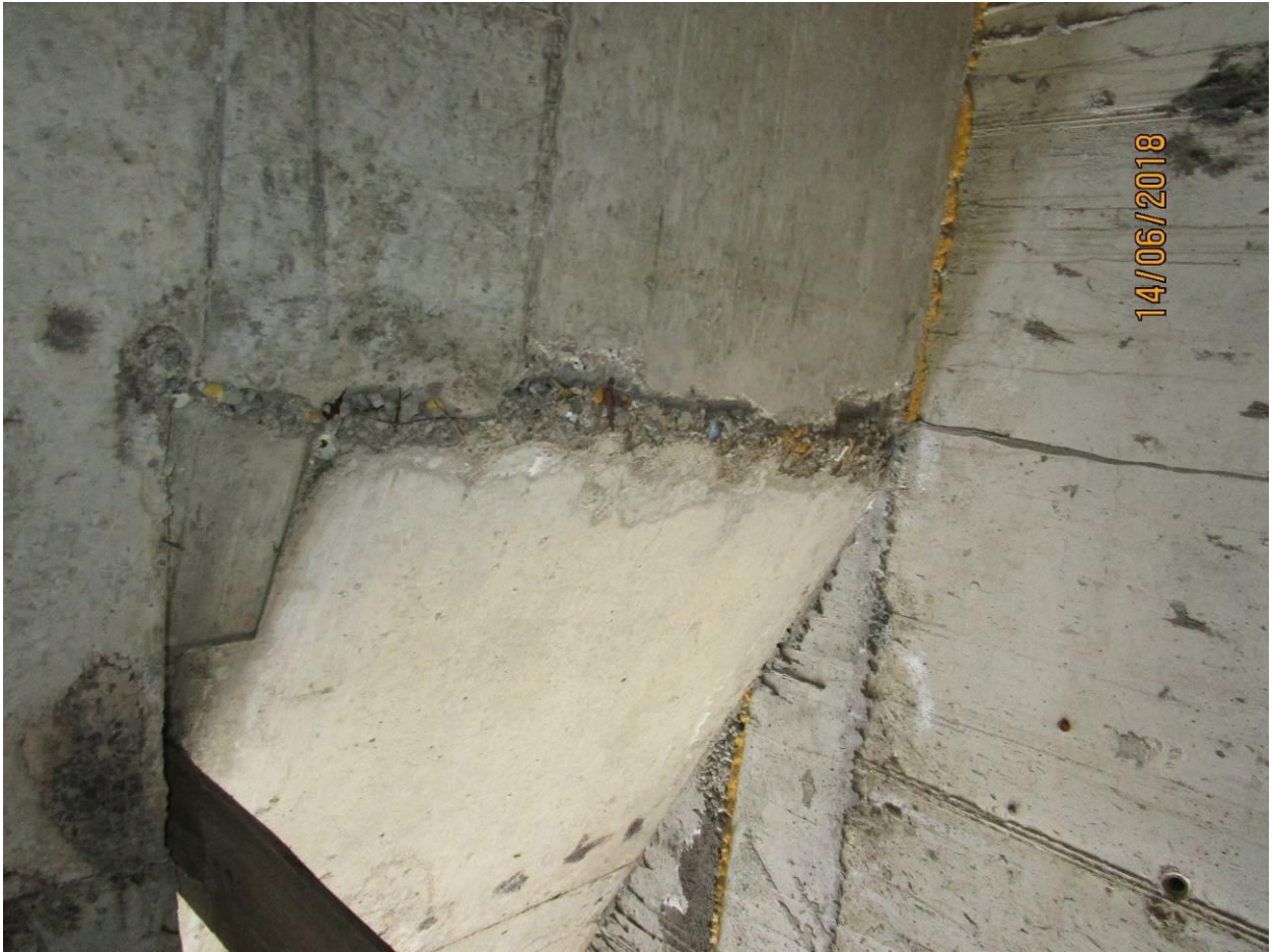
Фото 30. Примыкание лестничного марша к площадке имеет холодный шов, отсутствует уплотнение и однородность бетонной конструкции, оголена арматура в осях ВК/В8-В9 с отм. 30,600 (9 эт.).
