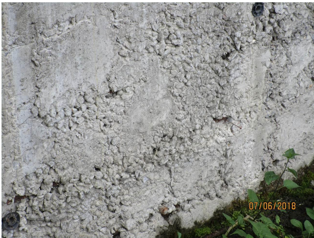
Фото 10. Бетон в стене в осях 9-10/Н с отм. 4,200 недоуплотнен до однородного состояния.
