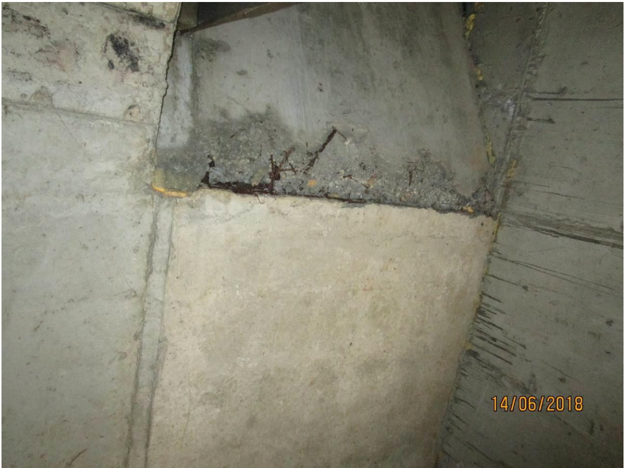
Фото 29. Примыкание лестничного марша к площадке имеет холодный шов, отсутствует уплотнение и однородность бетонной конструкции, оголена арматура в осях ВВ/В7-В8 с отм. 30,600 (9 эт.).
