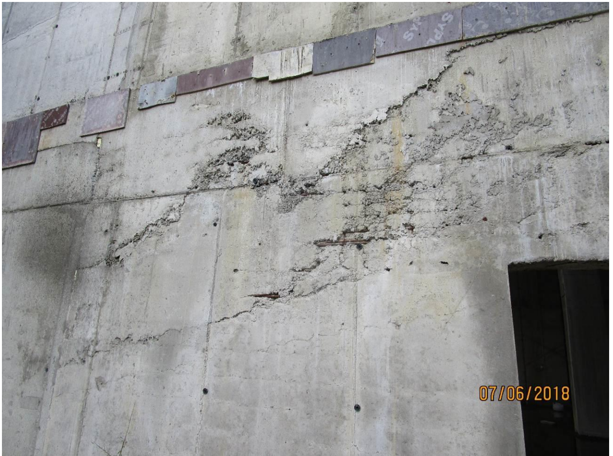
Фото 12. Бетон в стене в осях 9/Н-П с отм. 4,200 недоуплотнен до однородного состояния.
