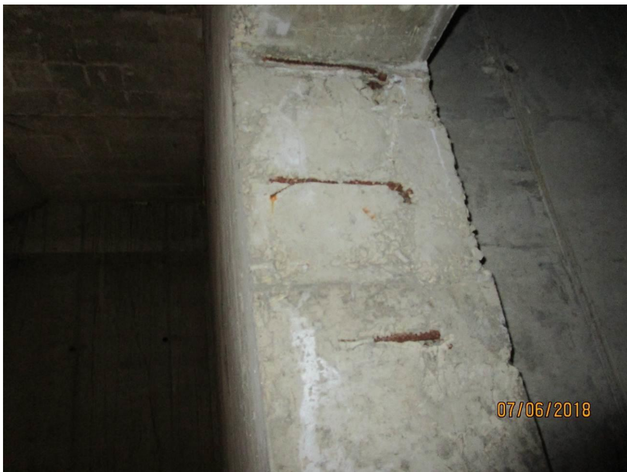
Фото 8. В проеме стены 12-13/И с отм. 0,000 из-за смещения каркаса оголена рабочая арматура.
