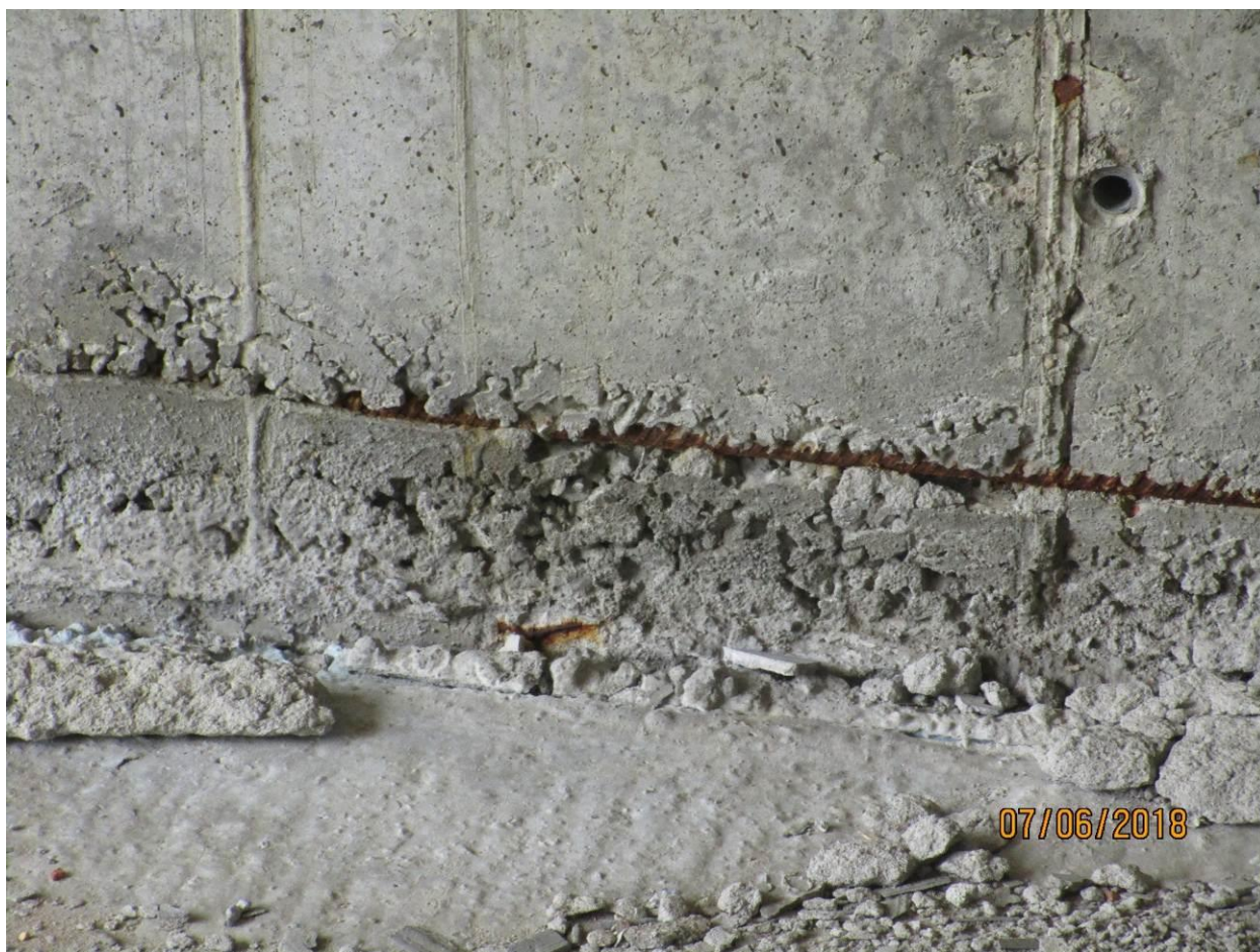
Фото 15. Конструкция стены в осях 3-5/К с отм. 8,400 недоуплотнен до однородного состояния и оголение арматурного каркаса.
